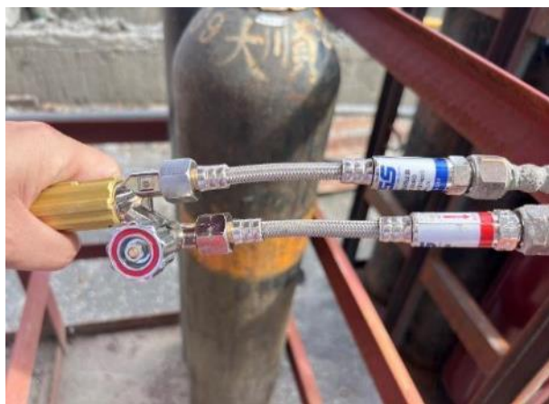
鋼瓶吹管裝設防逆迴火裝置OK
