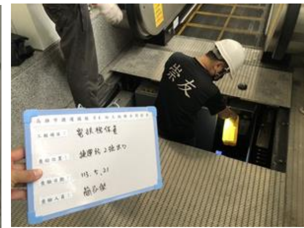
電扶梯例行月保養 無異常
